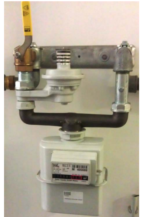
Abbildung 9.1: Einrohr-Gaszähler mit Passstück an einer Zweirohr-Gaszählerplatte mit Zählerregler
