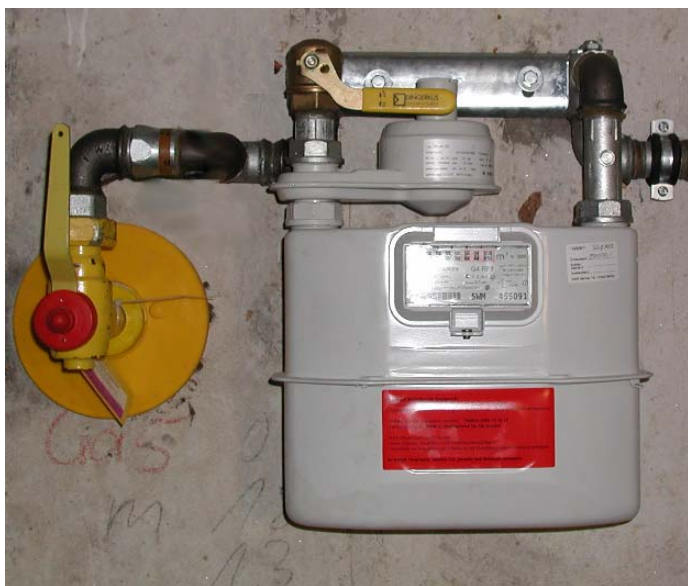
Einzelspartenanschluss mit Gaszähler und Zählerregler
